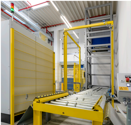
Automatisierte Förderanlage mit Verfahrwagen und Rollenbahnen
